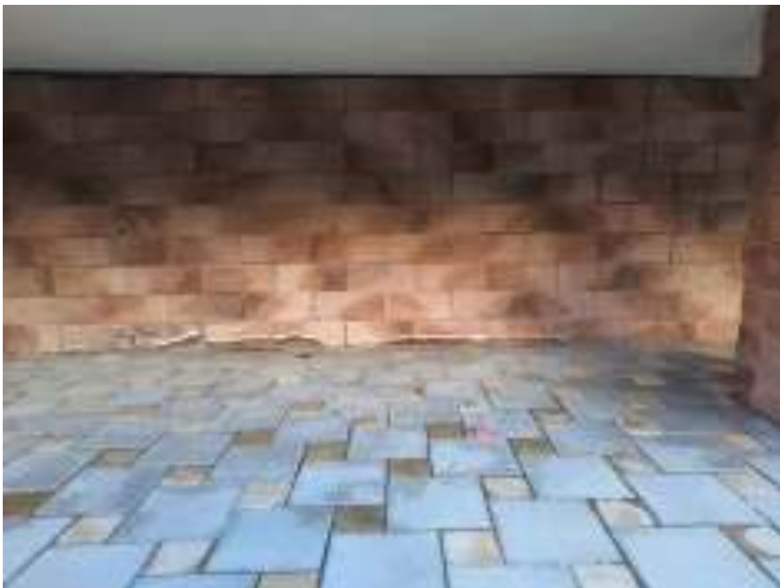
Фото 61 - Следы намокания фасада.
