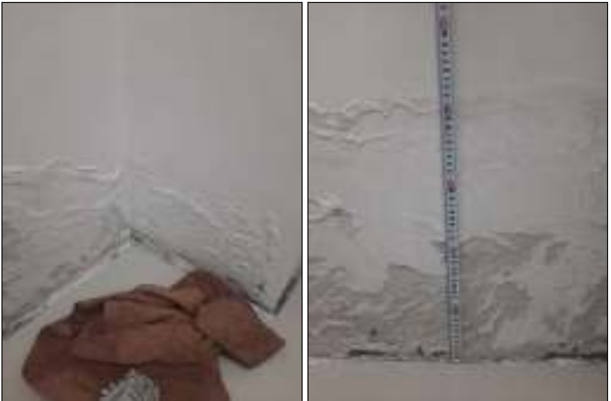
Фото 42, Фото 43 - Намокание стен в квартире №5а корпуса №1.
