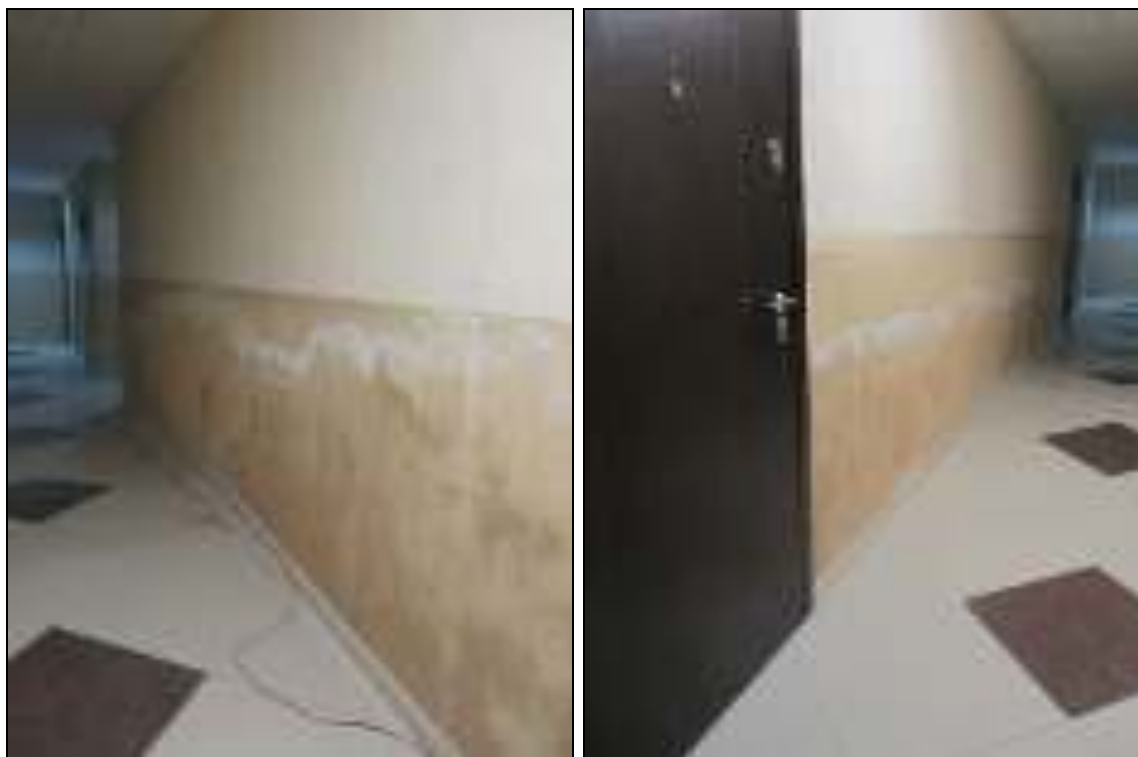
Фото 2, Фото 3 – Следы увлажнения стен, высолы в коридоре цоколя корпуса №5.
