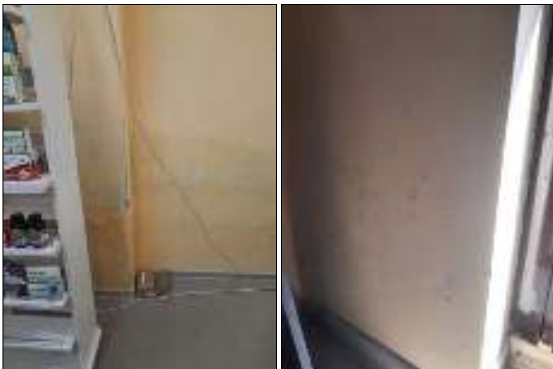
Фото 57, Фото 58 - Следы намокания стен в коммерческом помещении (аптека) корпуса №10
