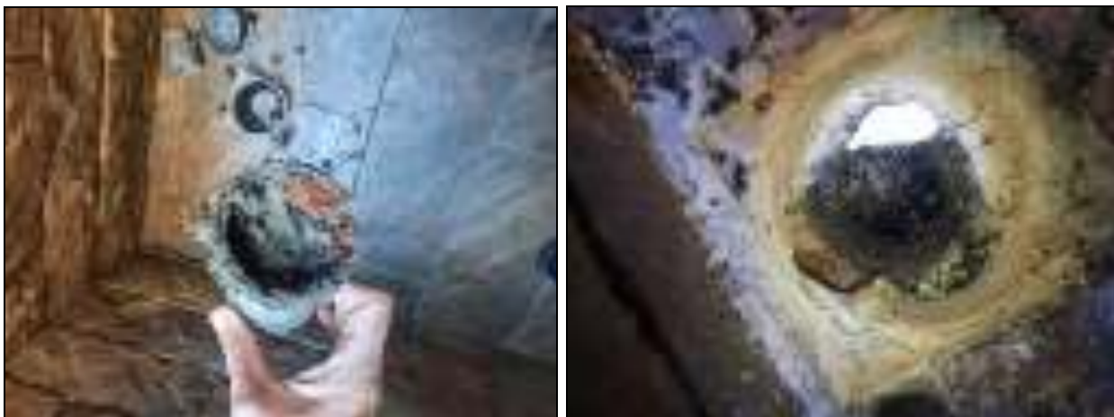
Фото 34, Фото 35 – Дренажная труба. Водоотвод из приямка цоколя.
