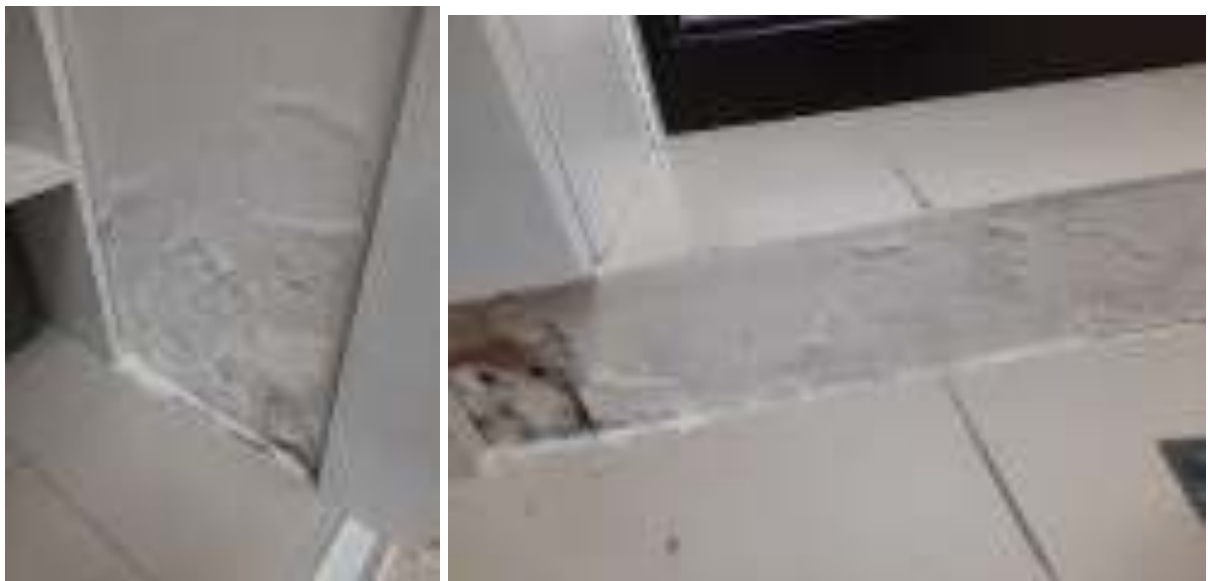
Фото 40, Фото 41 - Намокание стен в квартире №5а корпуса №1.
