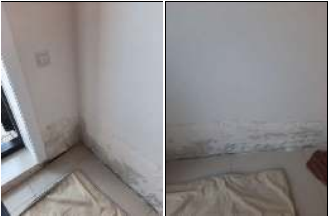
Фото 38, Фото 39 - Намокание стен в квартире №5а корпуса №1.
