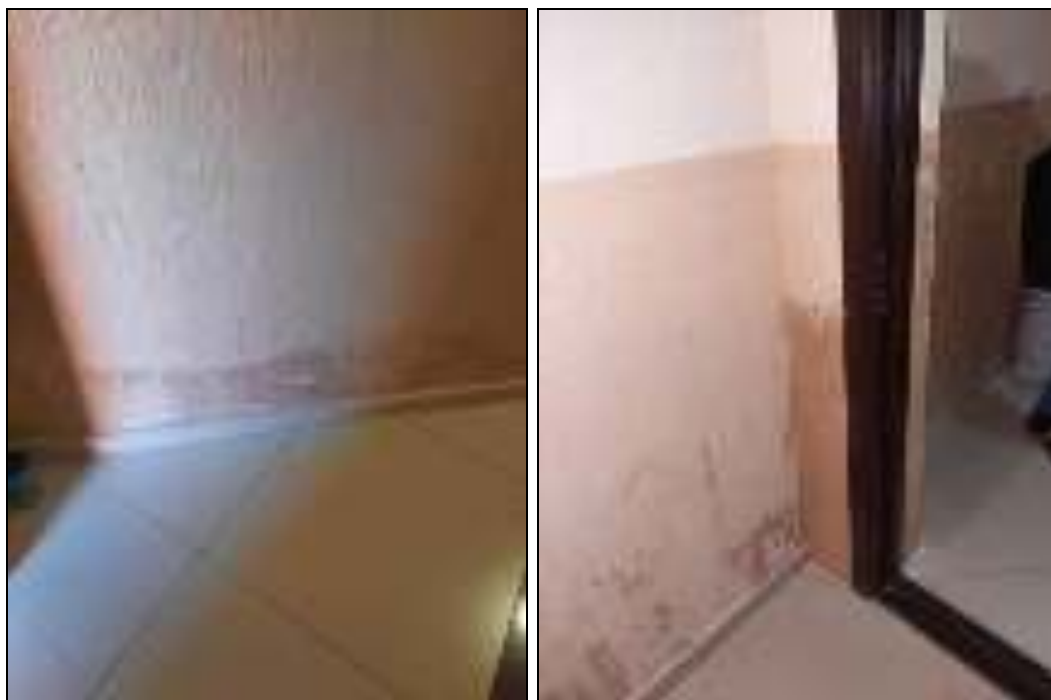
Фото 47, Фото 48 – Следы намокания в коридоре цоколя корпуса №8
