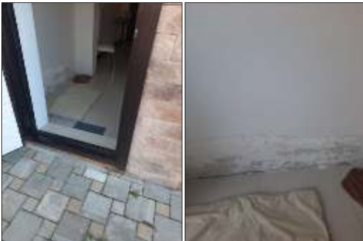
Фото 36, Фото 37 – Намокание стен в квартире №5а корпуса №1.
