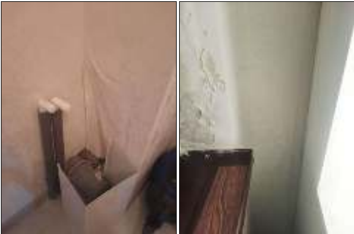
Фото 18, Фото 19 - Следы увлажнения стен в квартире №5ж. Отслоение обоев и шпатлевочного слоя
