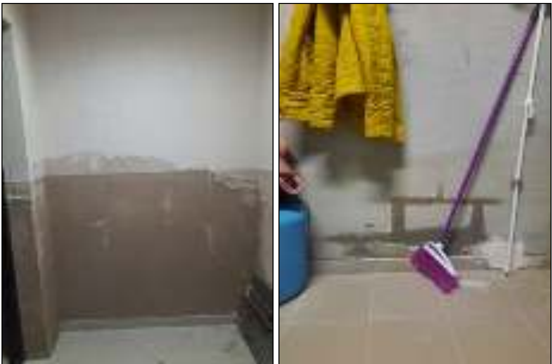
Фото 53, Фото 54- Следы намокания в коридоре и помещении насосной цоколя корпуса №8
