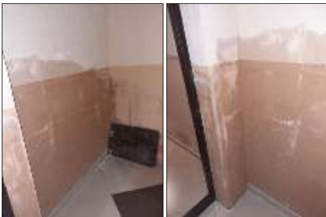
Фото 49 Фото 50- Следы намокания в коридоре цоколя корпуса №8
